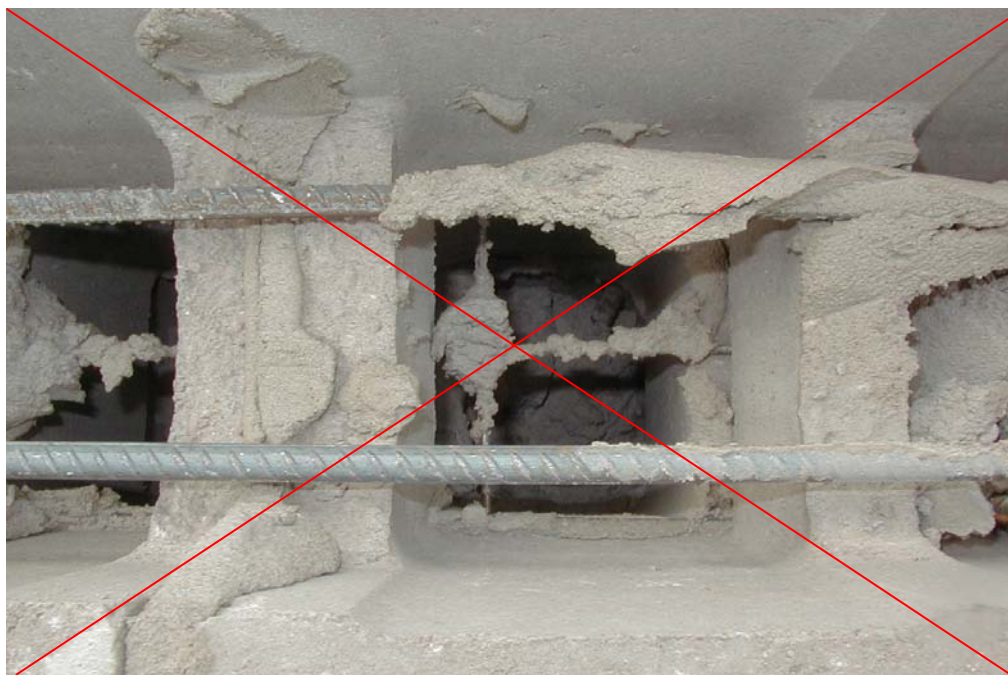
Фото 3. Недопустимо выполненная кладка (раствор осыпался в пустоты, предназначенные для бетонирования).
